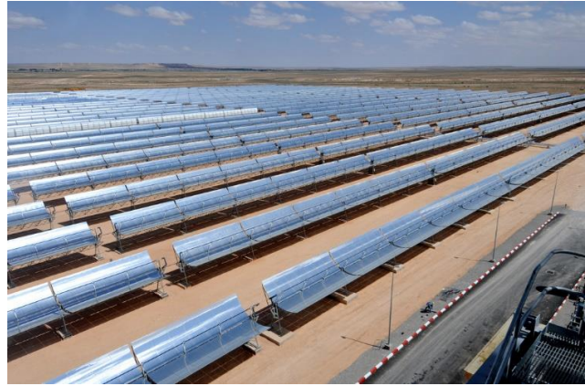
محطة توليد الكهرباء بالطاقة الشمسية والغاز في عين بني مطهر التي تعتمد على تقنية الطاقة الشمسية بالدائرة المشتركة. تُعد قدرة استغلال الطاقة الشمسية عبر منطقة لشرق الأوسط وشمال أفريقيا كبيرة جداً. يمكن إدراج الطاقة الشمسية في الزراعة وإنتاج الطاقة وحتى تحلية المياه.
